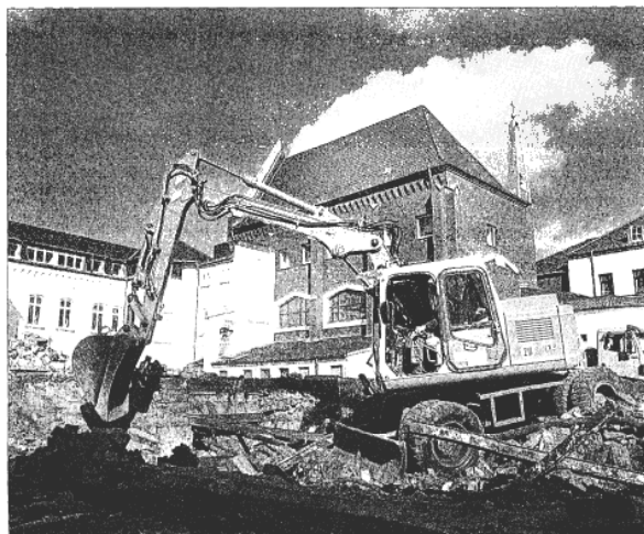
Die Bagger rollten, an der Trichtergasse/Ecke Paulusstraße wird ein Neubau hochgezogen. Die voraussichtliche Bauzeit des Pflegeheims wird 18 Monate betragen. Foto: Harald Kroemer
